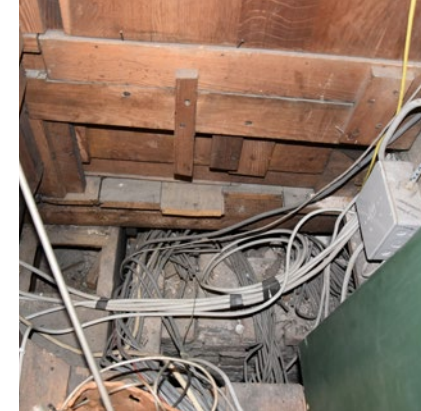
Wirrwar mit alten Pneumatikröhren und Kabelsalat im Untergehäuse, typisch für die ganze Orgel!
